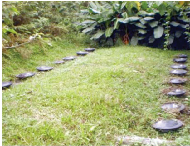
Foto 24. Sistema de biofiltro SFFOQ
