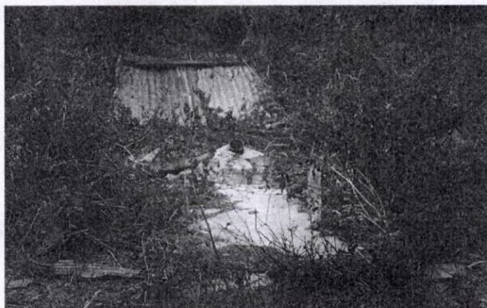
Foto 4. Estado actual de unidad sanitaria
