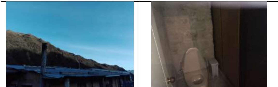
Imágenes 5 y 6. Estado de la cubierta y batería sanitaria dentro de la vivienda.
