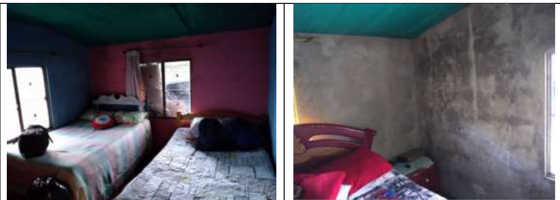
Imágenes 7 y 8. Interior de los dormitorios, posible presencia de humedades, cielo raso en polisombra.
