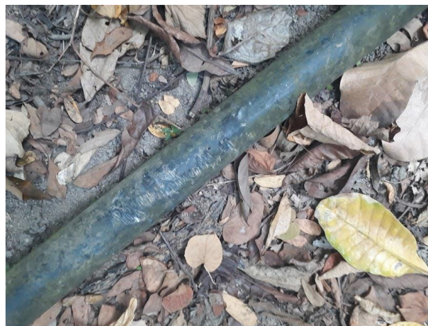
Fotografía 11. Estado tuberías existentes para conducción de agua
