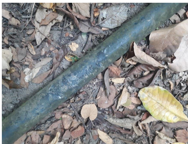
Fotografía 2. Estado tuberías existentes para conducción de agua
