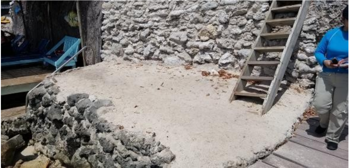
Fotografía 4. Relleno realizado con piedra coralina, cemento y arena entre las dos plataformas construidas.
