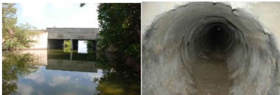
Figura 36. Box-coulverts y alcantarillas bajo la carretera Barranquilla - Ciénaga
