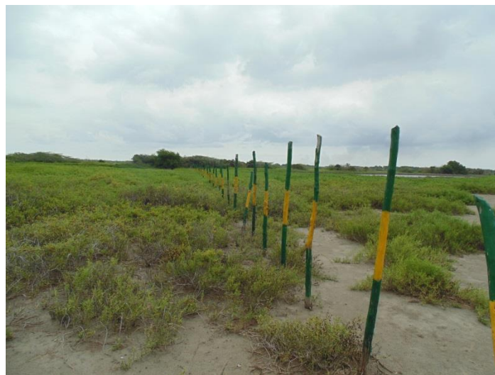
Postes para la intalación del cercado que separa la VIPIS de las empresas portuarias SODINTEC y RETRAMAR
