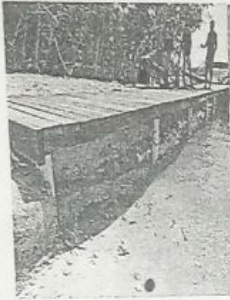
Infraestructura protección costera
