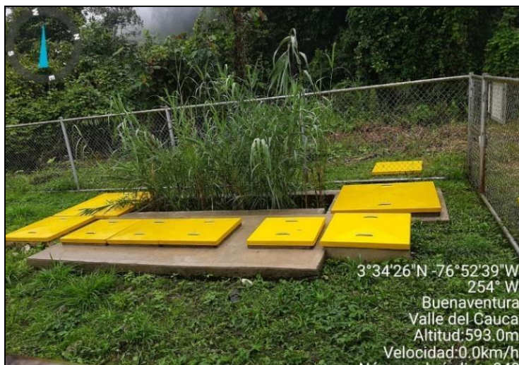
Foto 1. Sistema Séptico Oficina Automotriz No. 1
