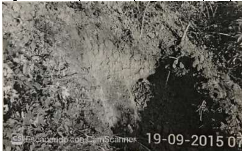
Imagen 5. Excavación presuntamente para instalación de pozo séptico
