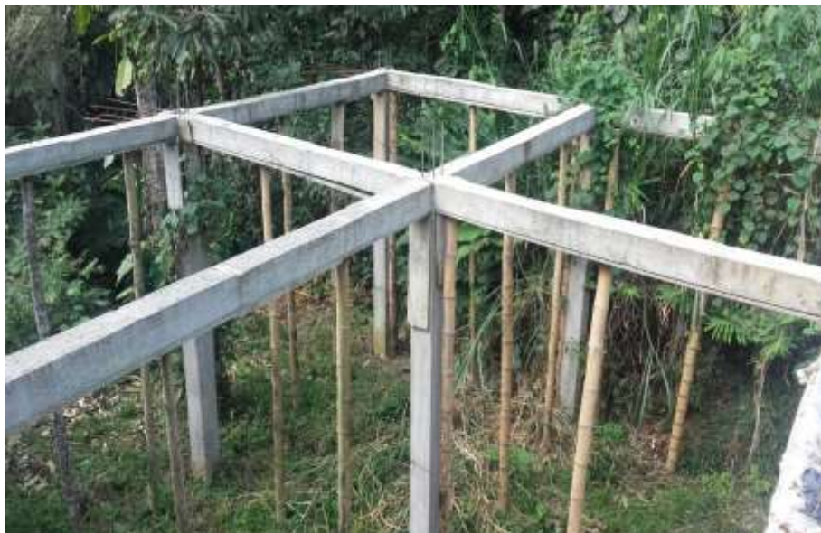
Tomada del informe técnico inicial No. 20177660005366 del 20 de octubre de 2017
