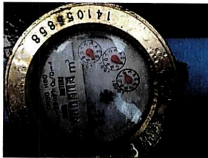
Imagen 1. Micromedidor instalado en funcionamiento.
