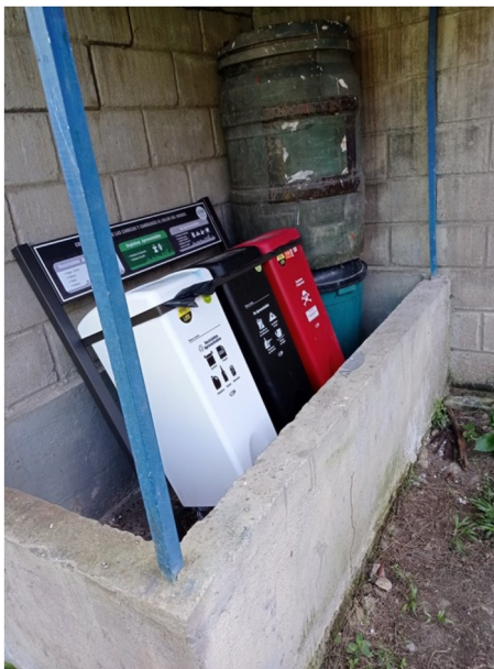
Imagen 4. Almacenamiento inadecuado de residuos comunes dentro del dique de contención de residuos peligrosos - Estación Don Diego
