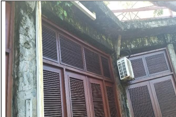
21. Equipo de Aire Acondicionado de los baños sauna.
