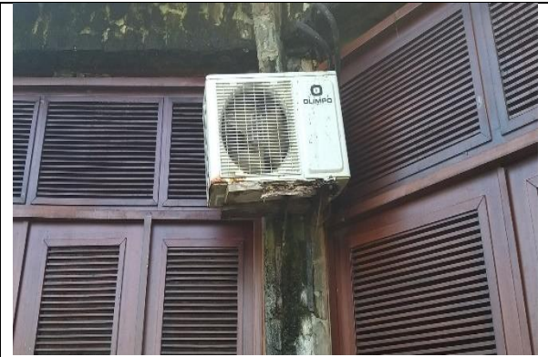
22. Equipo de Aire Acondicionado de los baños sauna
