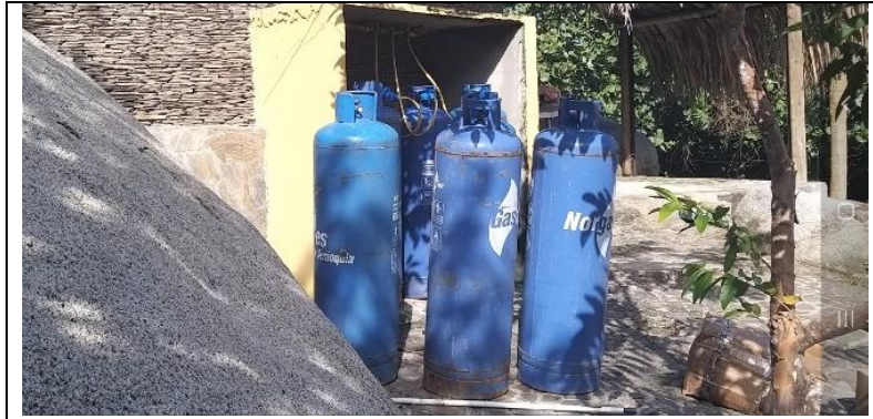
27. Zona de tanques de gas propano para la cocina.
