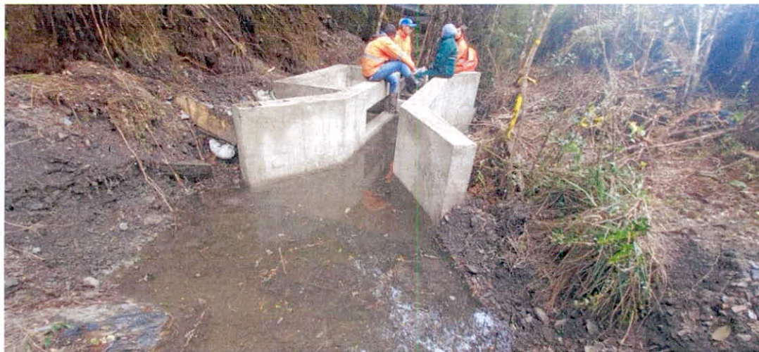
Figura 1. Quebrada Sin Nombre Sector Paila Nueva y Paila Antigua. Fuente. Visita técnica 7 de marzo de 2023.
