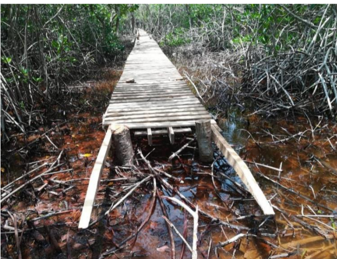
Fotografía 2. Registro del área que fue talada y donde se construye un sendero en madera. Nótese que el terreno es inundable. Are de recuperación del PNNCRSB
